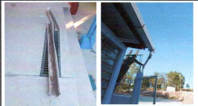
Foto 4: Canales en mal estado e instalación de nuevos
